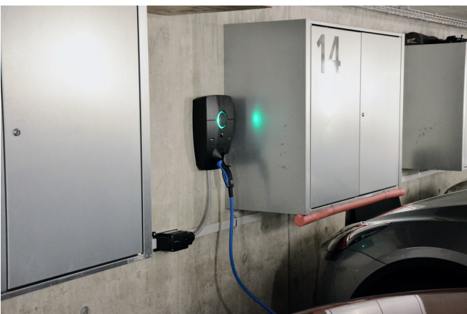
Ladepunkt für Elektrofahrzeuge im Zusammenspiel mit dem Energiemanagement-System.
