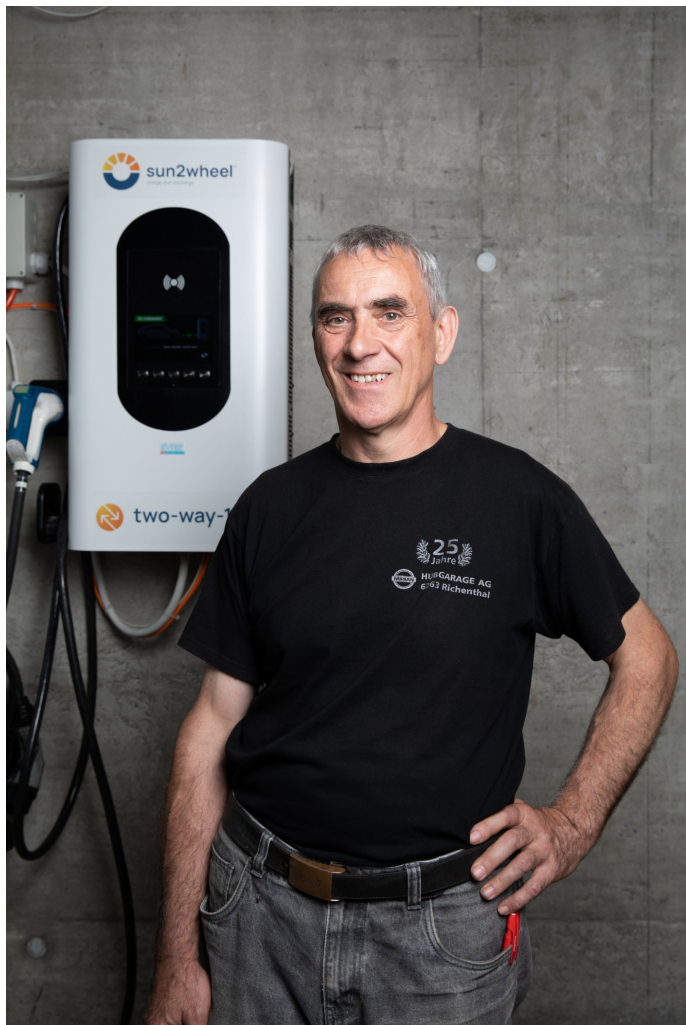
Hans Giger von der Hubgarage in Richenthal nutzt eine two-way-10 Ladestation, um Hebebühnen und Beleuchtung mit eigenem Solarstrom zu betreiben.
