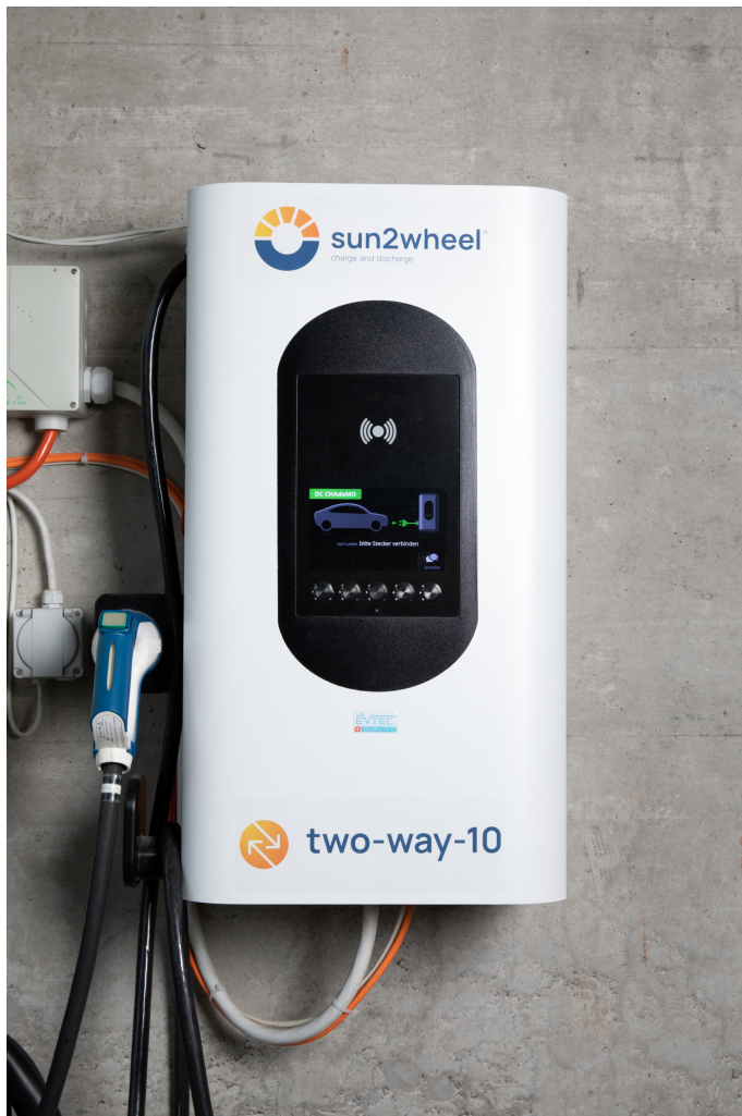
Bidirektionale Ladestation two-way-10 von sun2wheel im Betrieb.
