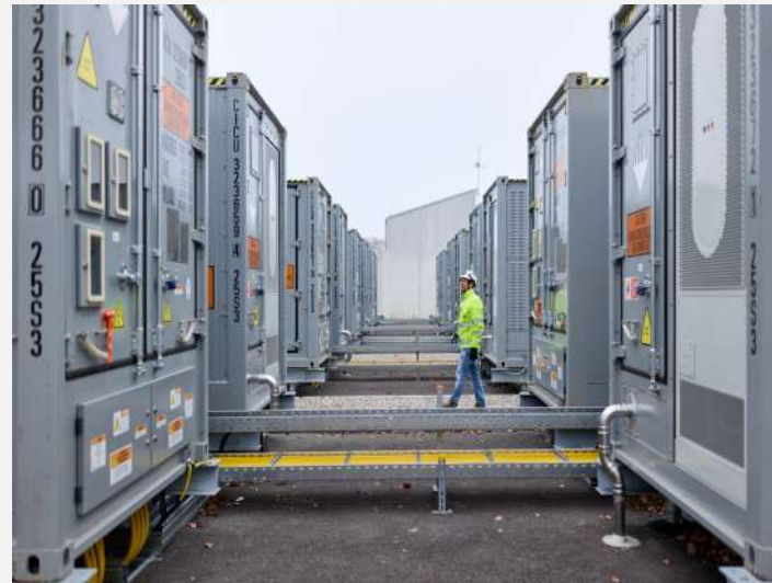
Batteriespeicher Kappel SO
