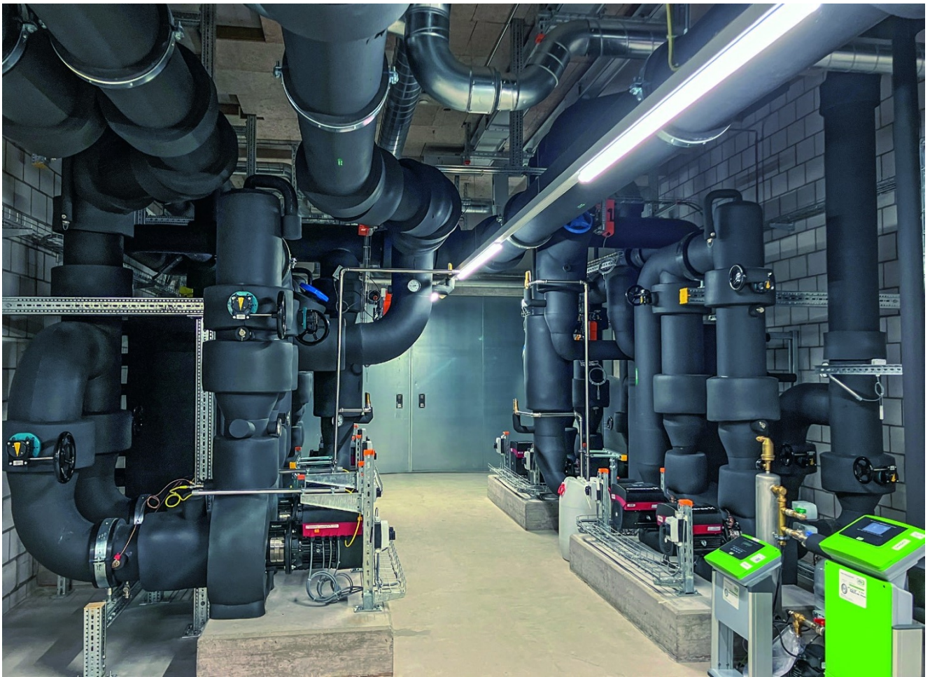
Moderne AI-Rechner erzeugen hohe Energiedichten und erreichen Betriebstemperaturen von bis zu 100 °C.
